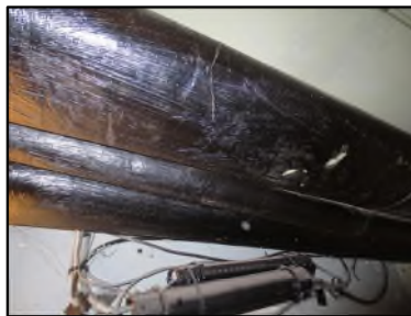
Photo N° 616 ECH-N°2 CALORIFUGEAGE --COULOIR DE CAVE Conduits de fluide Laine minérale + enveloppe bituminée
